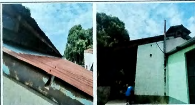
Foto 9: MODULO B Vista Lateral de modulo de aula, vista de cubierta de lamina de zinc en mal estado, se debera sustituir por lamina troquelada cal 26.
