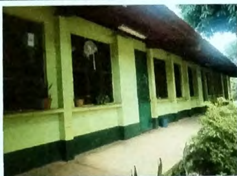
Foto 7: MODULO B Costanera de metal corroidas y lamina totalmente pandeada y rota, se sustituirá por lamina troquelada cal 26 y se dará mantenimiento a estructura de metal.
