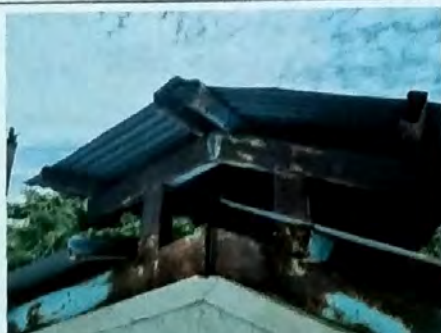
Foto 11: MODULO B Costaneras en mal estado corroidas y sustitucion de lamina de zinc en mal esado,
