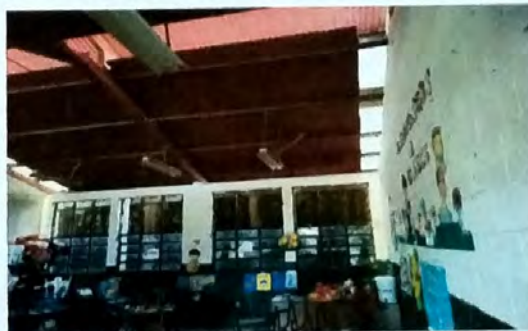
Foto 10: MODULO B Vista de corredor con lamina y costanera en mal estado.
