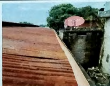
Foto 12: MODULO B Lamina de Zinc en mal estado,
