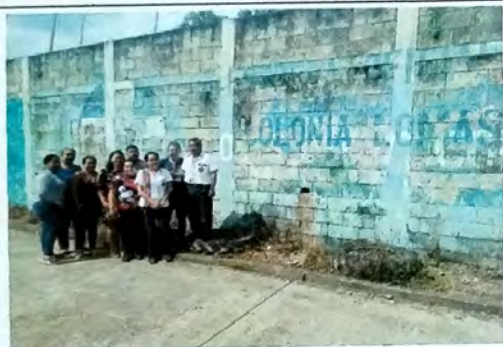
Foto 1: MODULO B Costanera de metal corroídas y lamina totalmente pandeada y rota
