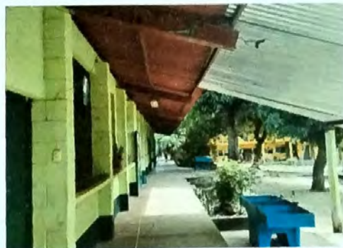
Foto 8: MODULO B Vista interna de aula y corredor con deterioro de estructura de metal y lamina doblada en pesimo estado. Se dará mantenimiento a estructura de metañ
