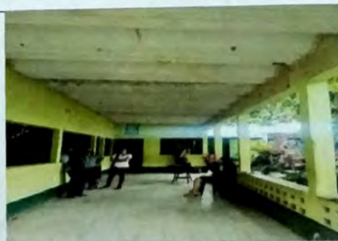
Foto 6: MODULO A Cambio de cubierta de Asbesto cemento en mal estado, se instalara por estructura metalica y lamina troquelada cal 26
